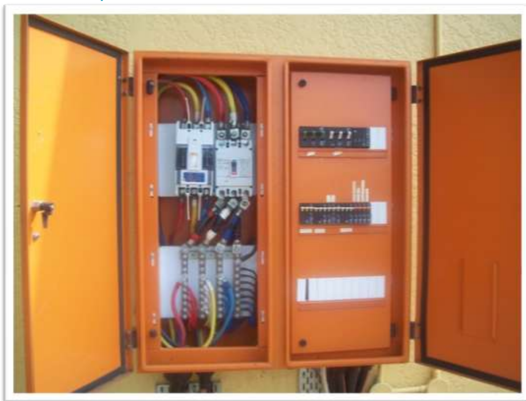
Anschlusskasten Haupthaus 125 A
