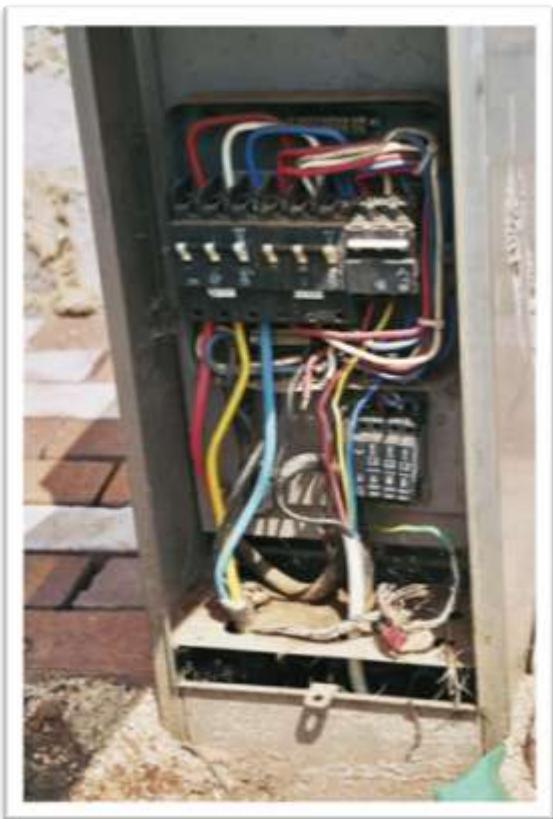
Hausanschlusskasten für die Wasserpumpe, das ehemalige Schulgebäude und die Häuschen der Freiwilligen.
